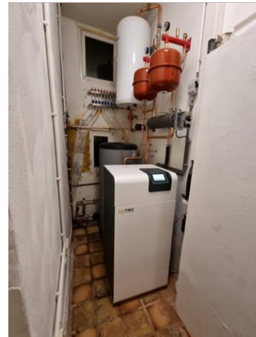
Figuur 5-1: Water/Water-warmtepomp installatie binnenshuis (bron: Indurio)
