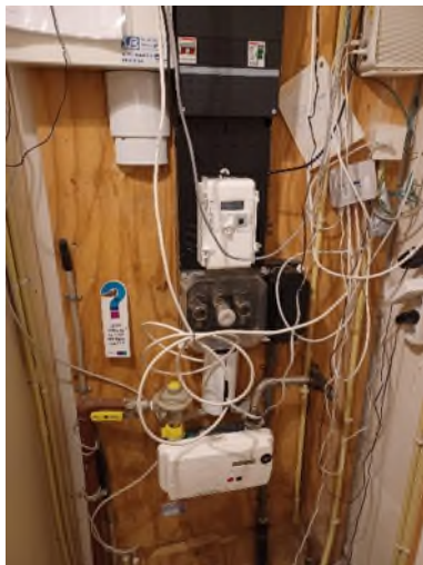
Meterkast van penthouse op bovenste verdieping.
